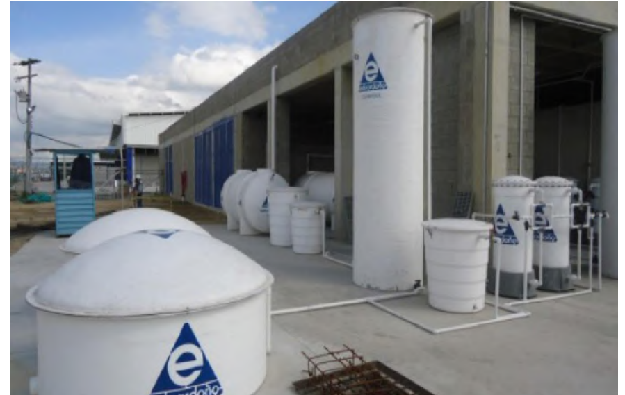
Planta de Tratamiento de Agua Residual -Chía
